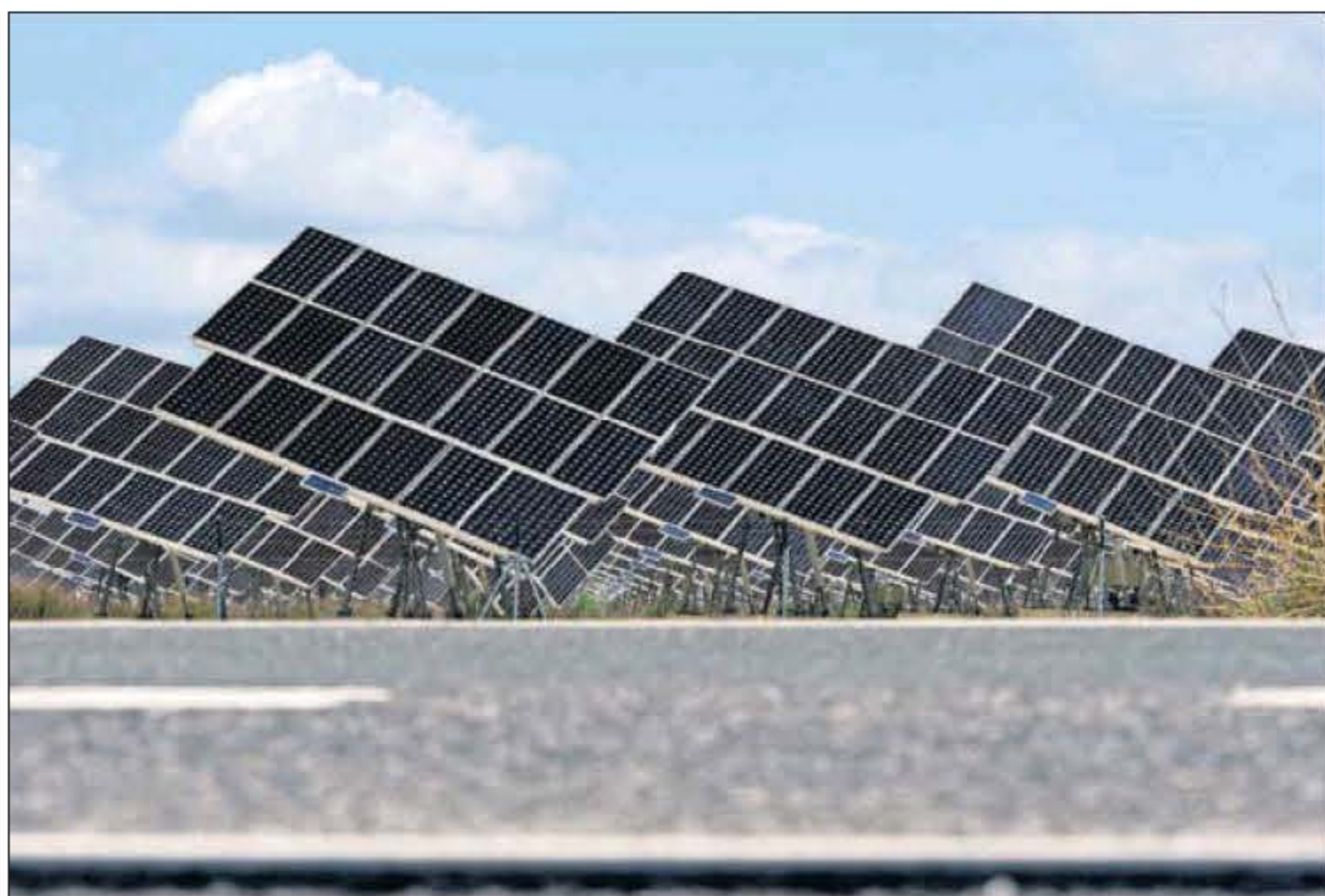
Planta de energía solar a las afueras de El Cuervo (Sevilla). / PACO PUENTES
